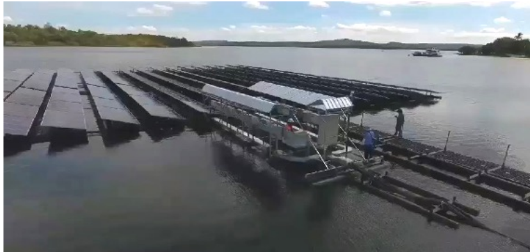
ภาพแสดงโครงการโรงไฟฟ้าพลังงานแสงอาทิตย์แบบติดตั้งบนน้ำ เขื่อนสิรินธร ขนาด 256 กิโลวัตต์
